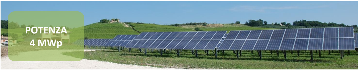
Figura 15 – Vista del parco fotovoltaico di Serre
