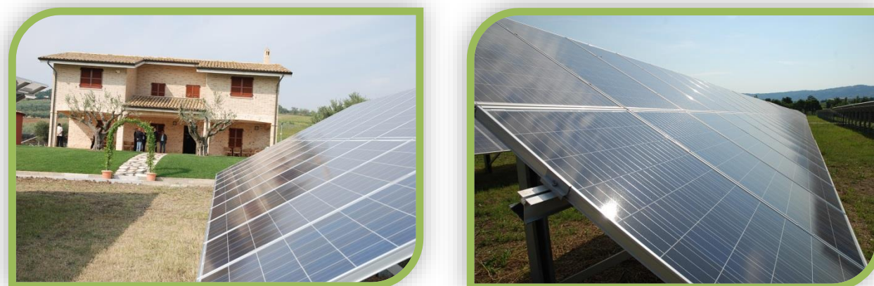
Figura 19 –Particolari impianto fotovoltaico “Serre”
